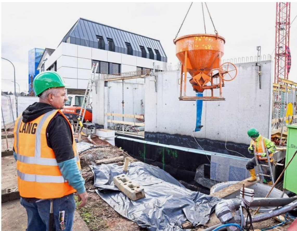
Bauarbeiten mit Recycling-Beton: In Haueneberstein entsteht mit dem Neubau der Artus-Gruppe ein Beispiel für nachhaltiges Bauen. Die komplette Wertschöpfungskette vom Rückbau bis zum Transportbeton liegt bei Recular in einer Hand. Foto: Chris Frühe
